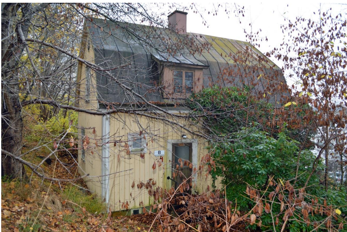
Bild 17. Efter decennier av uteblivet underhåll är Byggmästaren 18 numera i dåligt skick där bl.a. takläckage förekommer. Byggnaden har dock ett kulturhistoriskt värde. Ursprunglig huskropp är välbevarad och eftersom kringliggande bostadshus revs på 1950-talet minner den om områdets äldre struktur. Foto: Samuel Palmblad
