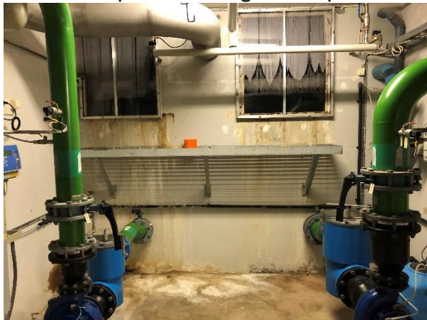
Foto 24, läckage/rinningar vid vägg.
