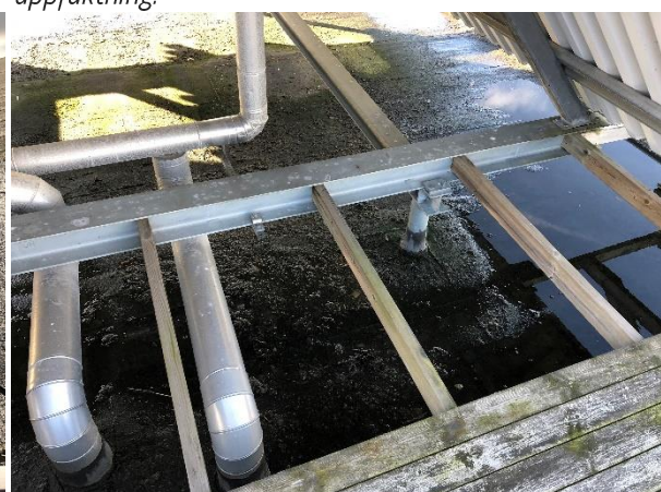
Foto 49, skräp och vatten står på tak i svackor tillhörande del 2B.
