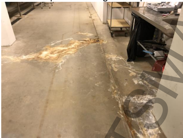
Foto 22, vätska trycker in genom betongplattan
