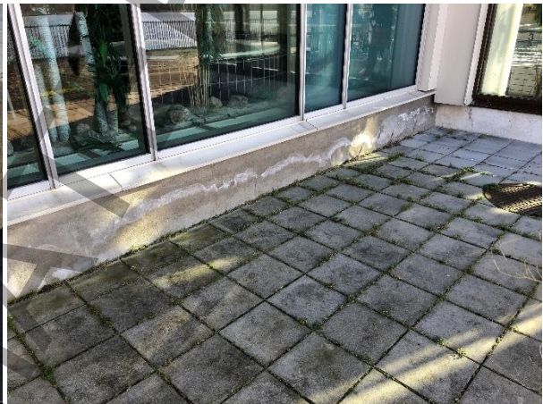
Foto 56, fuktig sockel och salt/kalkutfällningar del 4.
