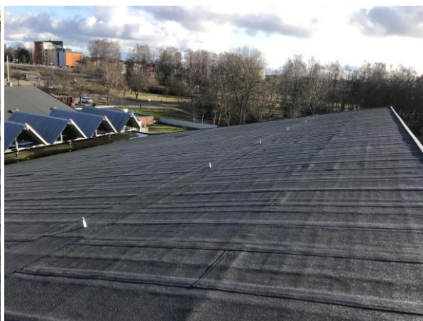
Foto 52, ojämnheter i undertaket.
