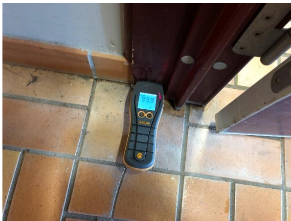
Foto 10, städ 3110, fuktskador i vägg till höger.
