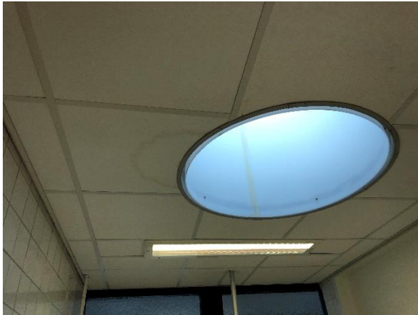
Foto 11, spår av uppfuktning i tak, herrarnas dusch
