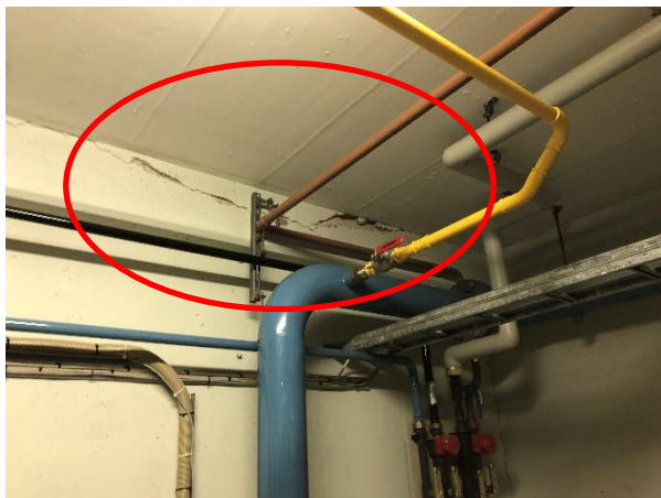
Foto 34, spricka i takvinkel i betong.
