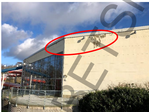
Foto 63, skador i fasad/ del 4.
