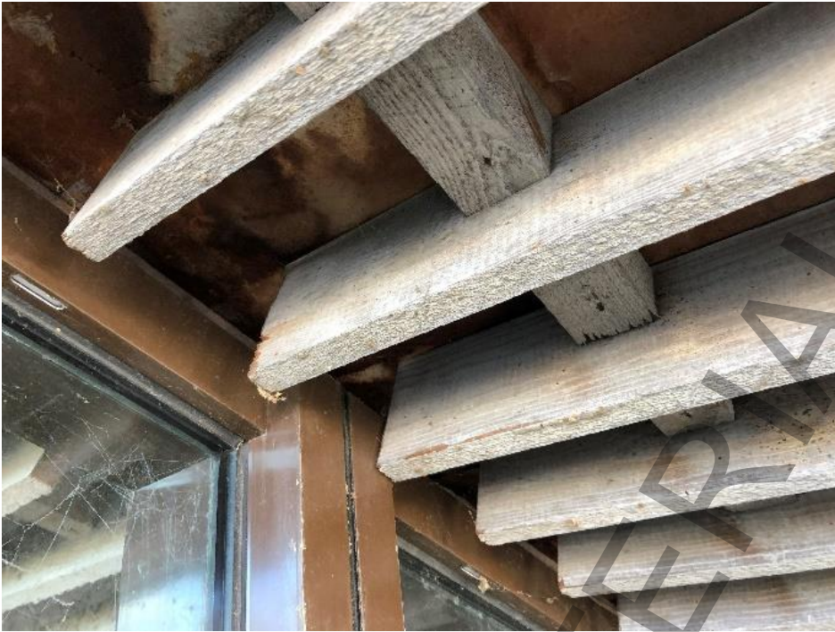
Foto 50, fuktskador i takutsprång.
