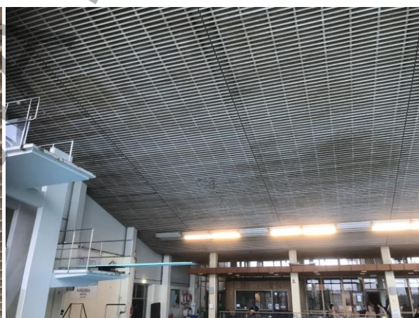
Foto 19, skador i tak, samt missfärgningar i tak.
