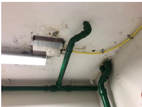
Foto 16, skador/läckage i tak i skytteavdelningen.
