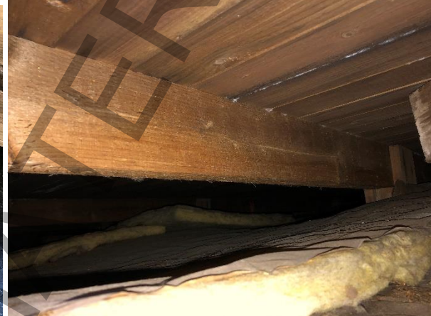
Foto 43, mikrobiella skador på råspont, spår av uppfuktning, i uppstolpad takkonstruktion.
