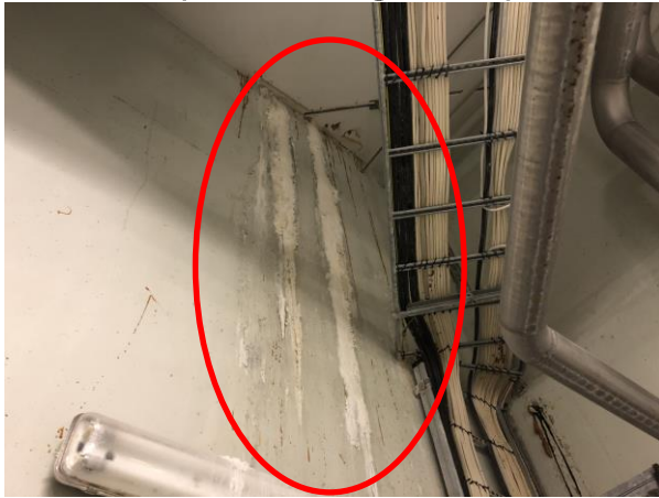
Foto 28, spår av läckage.
