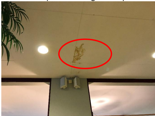
Foto 36, skador i innertak.
