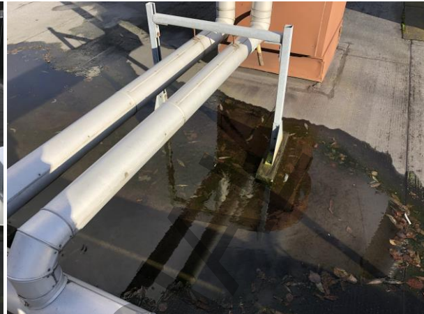
Foto 41, svackor i tak del 1.
