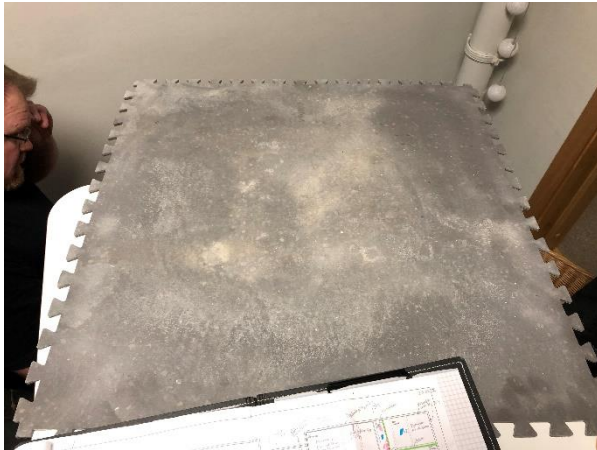
Foto 7, mikrobiell skada under nyare plastplatta.
