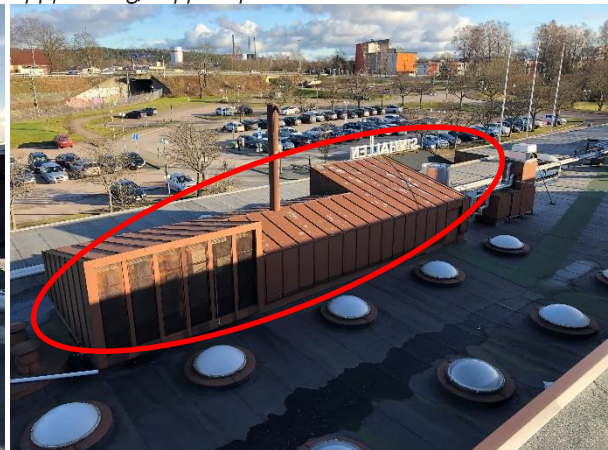
Foto 45, bristfälligt underhåll av plåtklädda delar.
