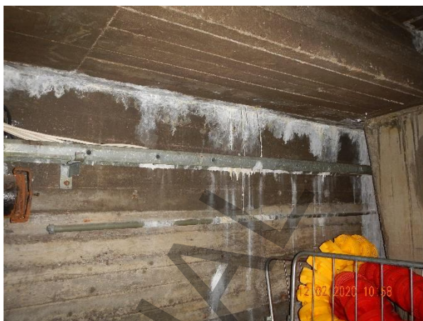
Foto 17, läckage/stalaktiter från pool i kulvert.
