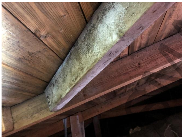
Foto 46, mikrobiella skador på råspont och takstol.
