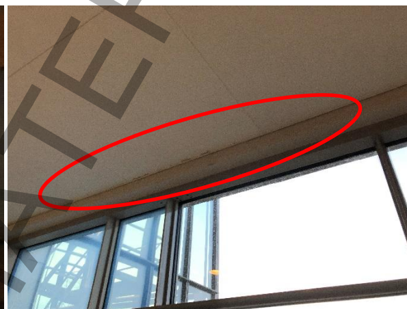
Foto 39, skador i innertak mot yttervägg.
