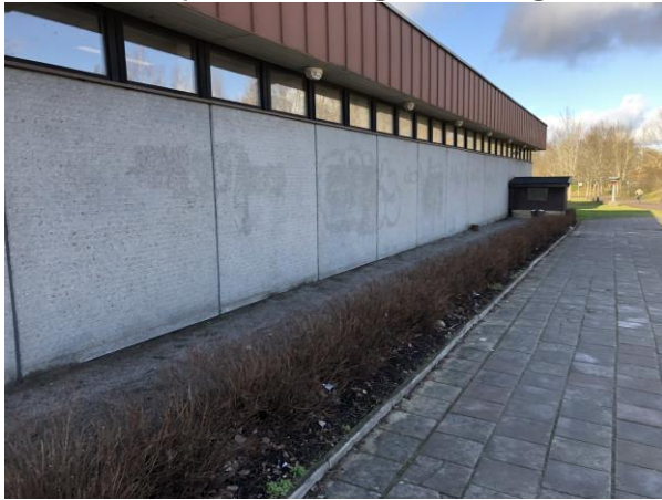
Foto 53, fasader äldre del med fuktuppsug.
