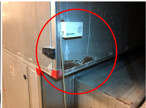
Foto 33, korrosionsskador på installationer.
