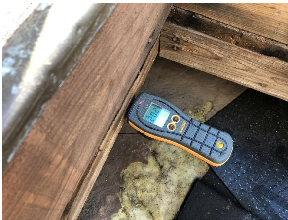
Foto 42, förhöjd fuktighet i takkonstruktionen.
