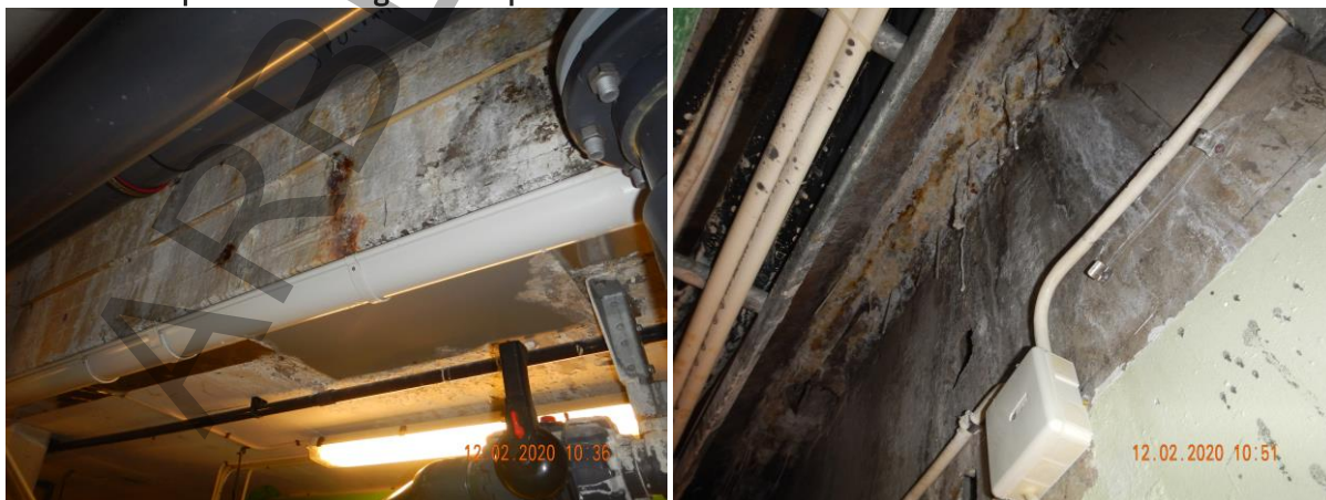
Foto 14, läckage och skador på btg-konstr. från 37m bas. Foto 15, skador på btg-konstruktioner i kulvert runt 37m.
