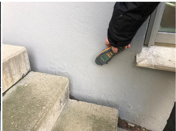
Foto 58, fuktigt i väggkonstruktionen del 4 vid trappa till vattenrutschkanan.
