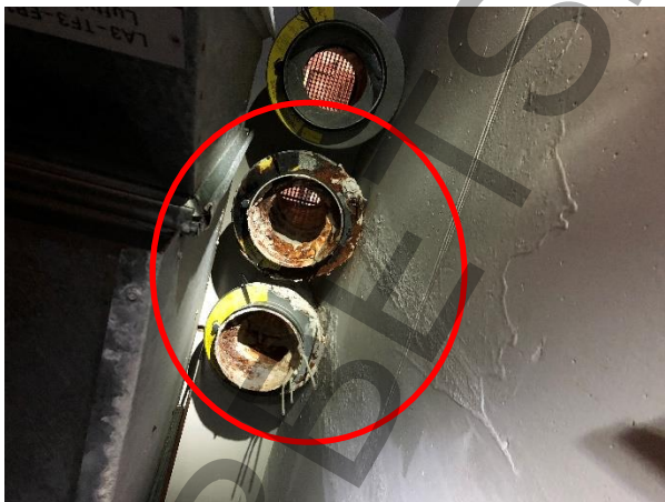
Foto 32, ventilation ovan trappa.
