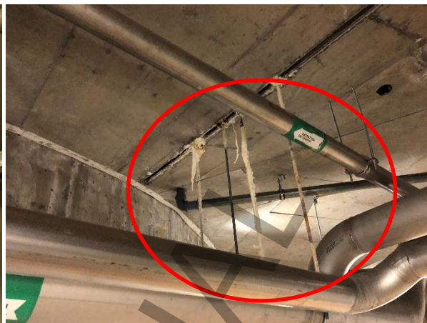
Foto 35, stalaktiter i taket, korrosion på installationer.
