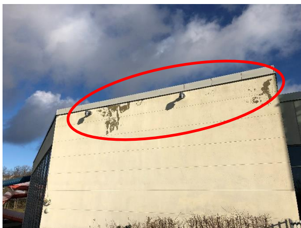
Foto 64, skador i fasad del/ 4.
