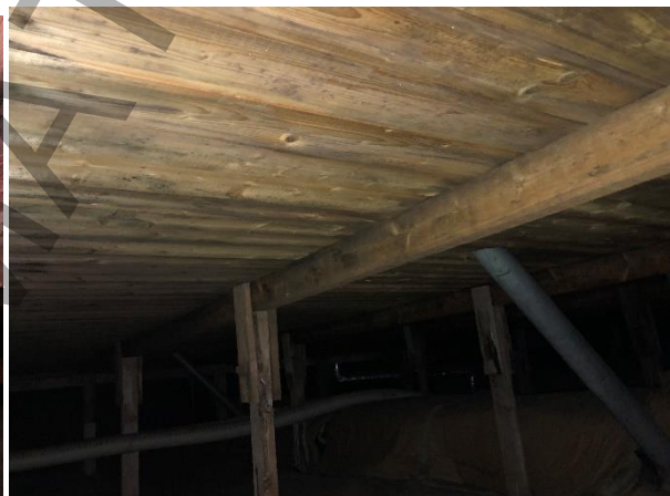
Foto 47, mikrobiella skador på råspont, spår av uppfuktning.
