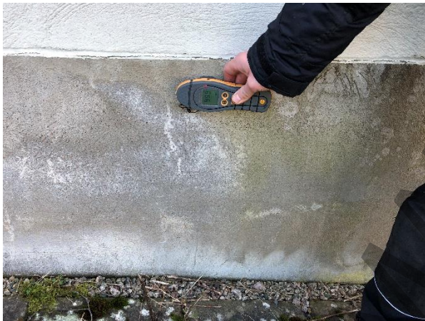
Foto 55, fuktig sockel/fasad del 3.
