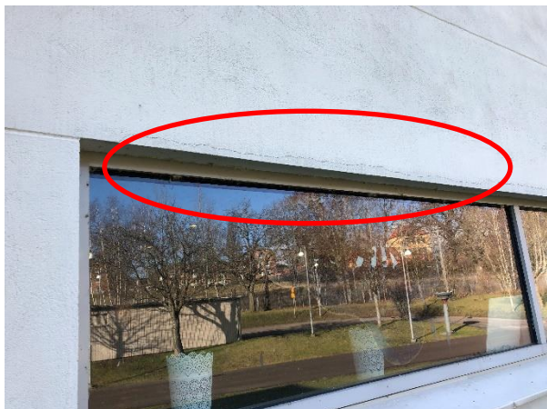
Foto 59, sprickor i putsade smygar del 3.
