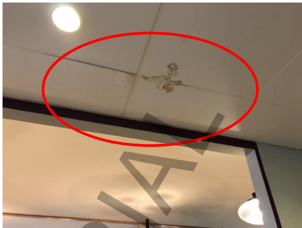
Foto 37, skador i innertak.
