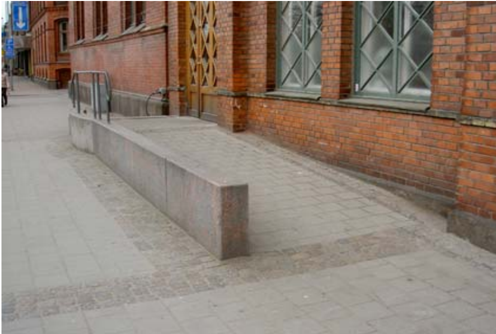
figur 31. Ramp i gatumiljö, avhjälpt hinder.
