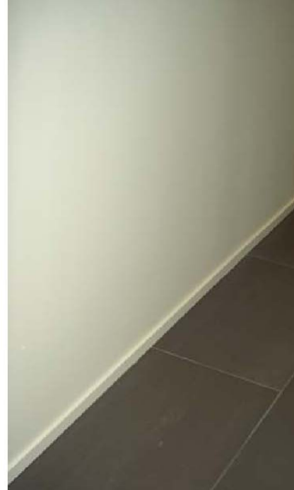
figur 7. Ljushetskontrast mellan golv och vägg.
